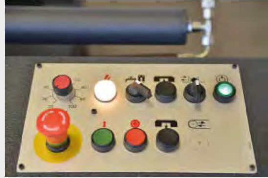
RESİM.: KONTROL PANELİ
